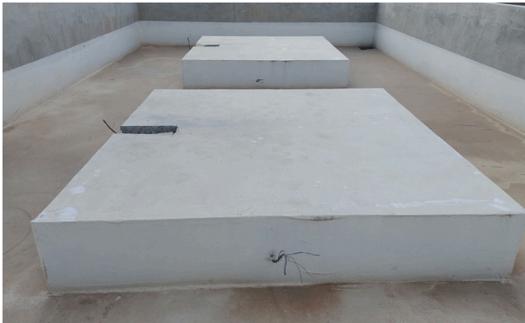
FOTO 6: Bases e diques de contenção de produtos
